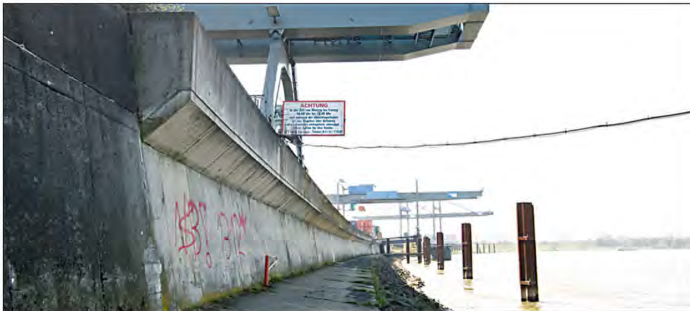
Muss der Grundstückseigentümer die Kaimauer am UCT-Gelände in Stürzelberg auf eigene Kosten sanieren? © Foto: Friedhelm Holleczeck
